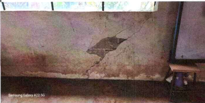
Foto 3: Esta imagen muestra en el interior del aula que esta totalmente deteriorada.
